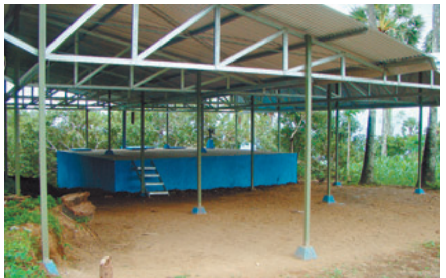
Ein fertiggestelltes Wasserreservoir. Das grossflächige Wassersammeldach erfüllt alle Erwartungen, und der freie Raum darunter dient gleichzeitig noch als Gemeinschaftsplatz, als Produktionsstandort und zeitweise sogar als Schulhaus.
